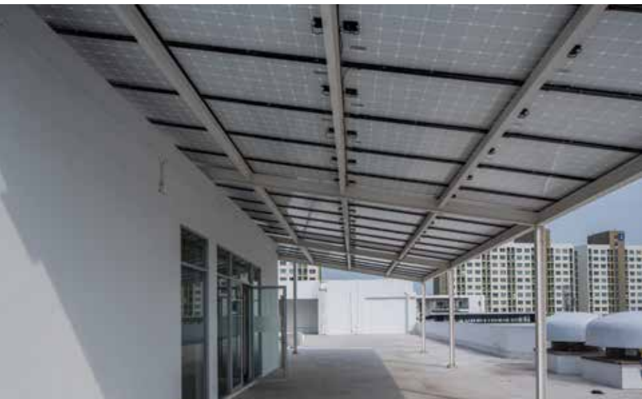
การติดตั้งแผงโซลาร์เซลล์ที่ทำหน้าที่เป็นหลังคาแบบกันสาดไปในตัว ให้ร่มเงา และยังผลิตไฟฟ้าพลังแสงอาทิตย์ให้เราได้ใช้ด้วย
